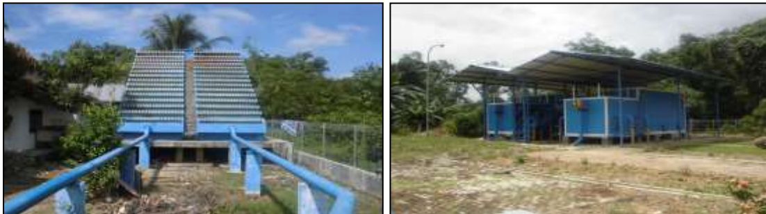
Gambar 3. 2 Kiri Unit pengolahan Aerasi (SPAM IKK Batu Mandi) dan Kanan Unit Pengolahan Lenngkap IPA Paket Konstruksi Baja (Paringin Selatan)
